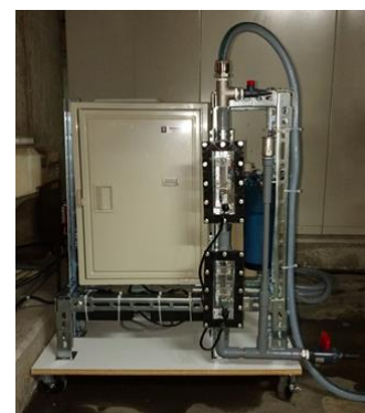
写真-2 オゾン供給装置
