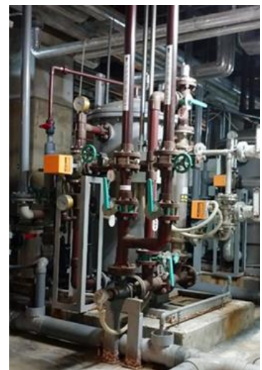
写真-1 循環式ろ過器
