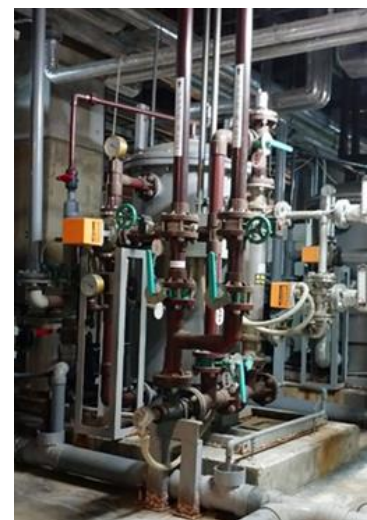
写真-1 循環式ろ過器
