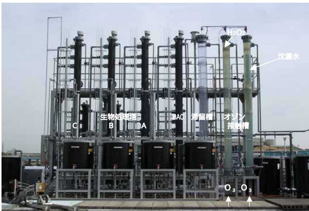
高度浄水処理実証試験設備（処理能力：45m 3 /日）
